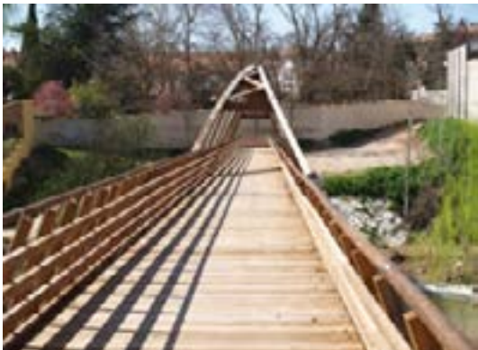
Figura 9. Deformación de los arcos.
