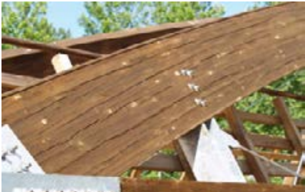
Figura 10. Fendas y delaminaciones.
