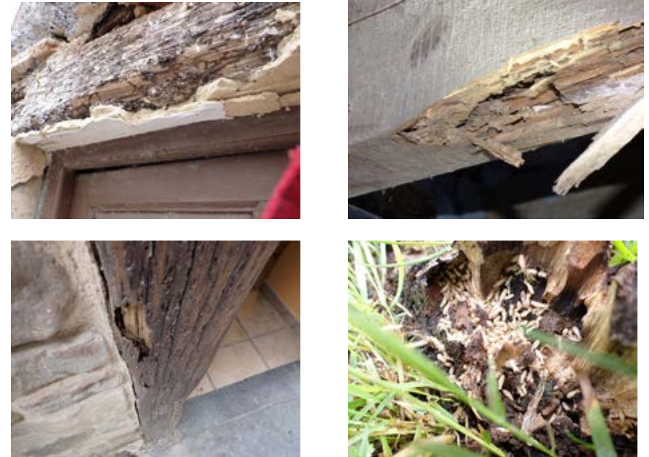
Figura 3. Areatza. Ejemplos de ataques de termitas en dintel, viga, pilar y tocón en zona verde.
