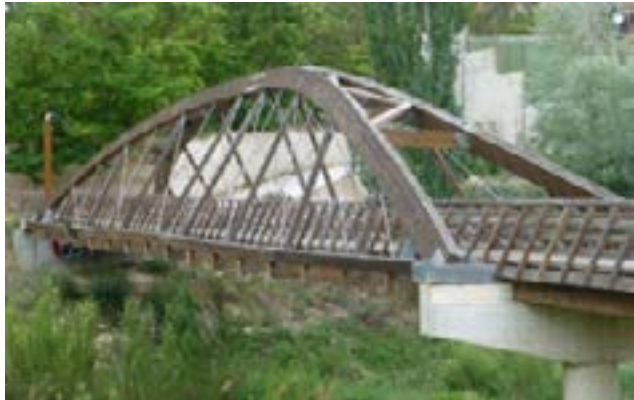
Figura 12. Deformaciones de las vigas del tablero.
