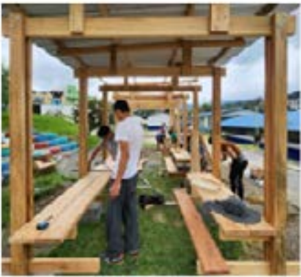
Figura 8. Anclaje de mobiliario
